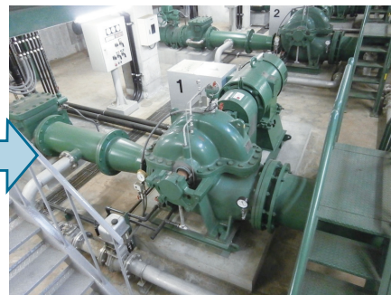
配水ポンプ 配水池の水を皆さんのご家庭までお届けしています
