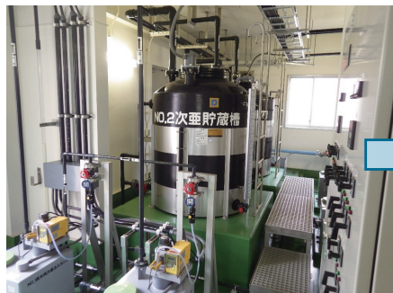
消毒設備 地下水を塩素により消毒処理して水道水にします
