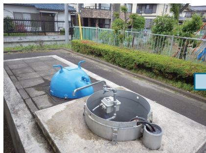
取水井 (しゅすいせい) 地下水をくみ上げます
