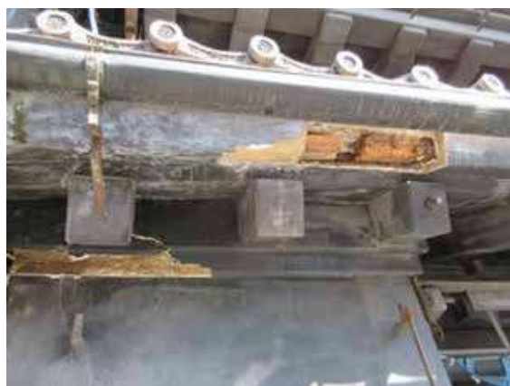
修理前（損傷箇所）
