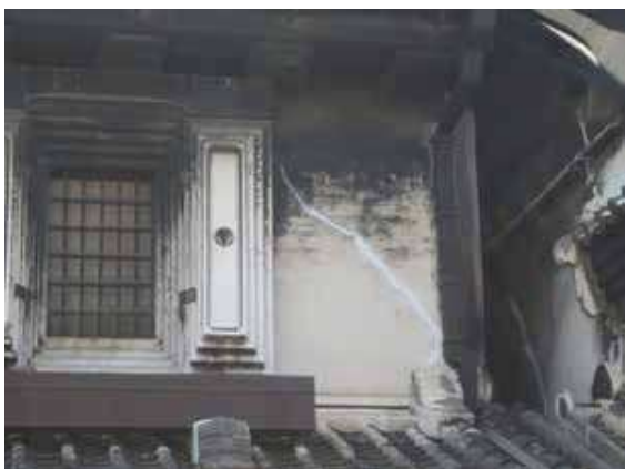
修理前（損傷箇所）
