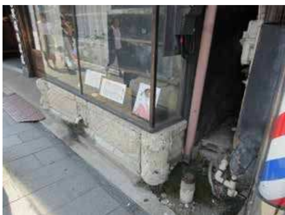
修理前（損傷箇所）
