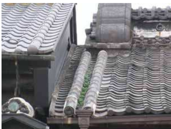
修理前（損傷箇所）
