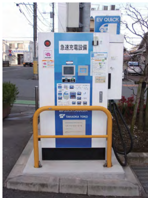
市庁舎北側電気自動車充電器
