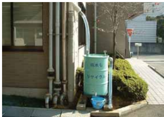
■公共施設の雨水貯留施設
