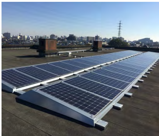
学校屋上の太陽光発電システム
