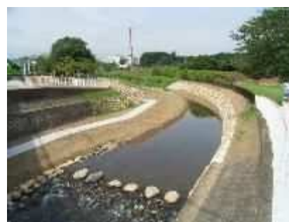
多自然型護岸(笠幡地区)
