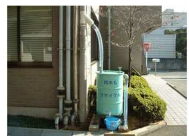
雨水利用（東清掃センター）
