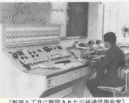
(新宿6丁目に新設された川越通信指令室)
