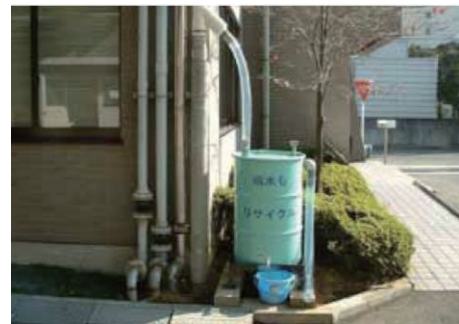
公共施設の雨水貯留施設
