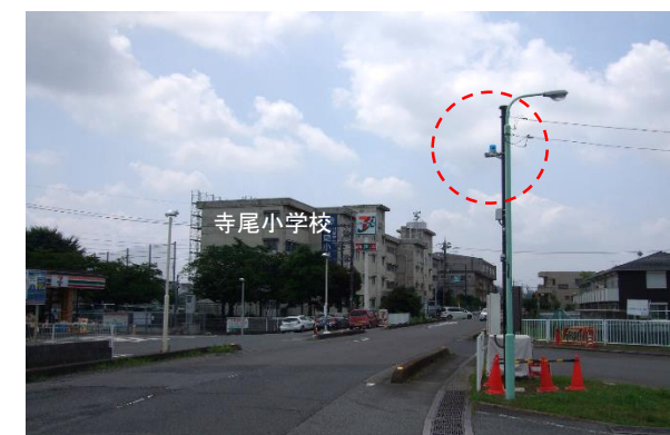
樋門閉鎖時に点灯する樋門表示灯を寺尾小学校北側に設置（令和元年7月完成）
