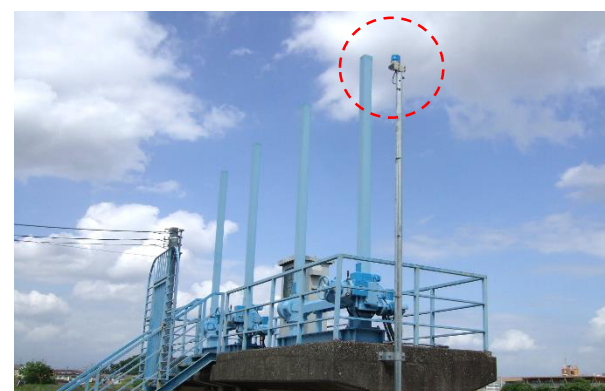
樋門閉鎖時に点灯する樋門表示灯を樋門に設置（平成30年9月完成）
