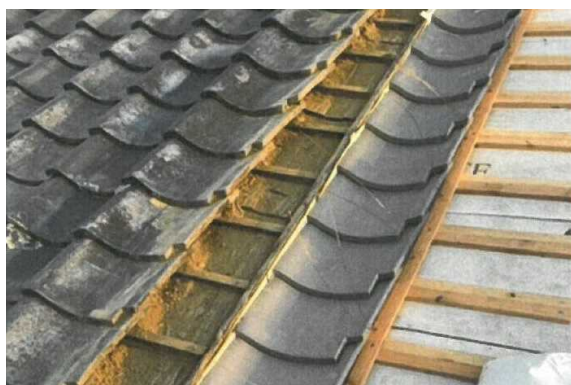
屋根下に防水シートを張り、その上に新しい瓦を葺き替える
