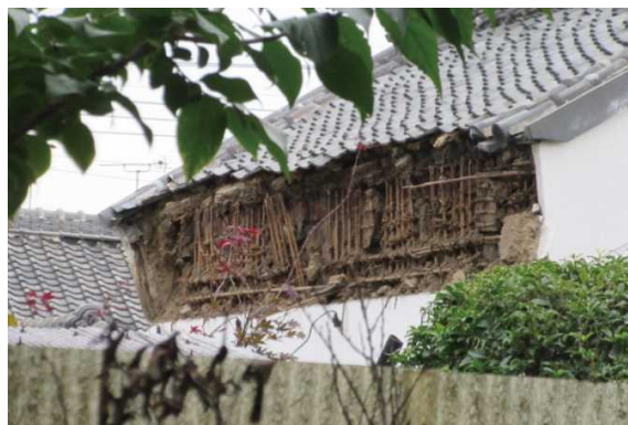
内蔵の東側の鉢巻部分の土壁が崩落し、内部の小舞が露出している
