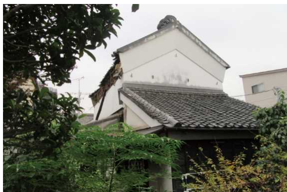
山下家住宅内蔵の状況 東側の土壁と屋根瓦が崩壊
