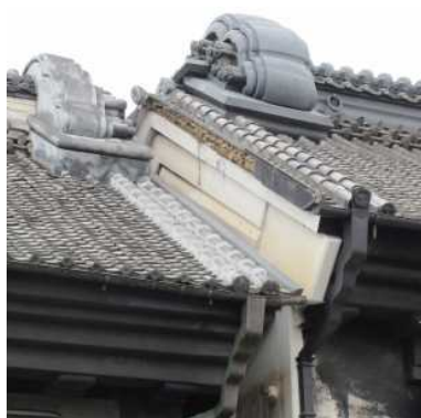
修理前（損傷箇所）
