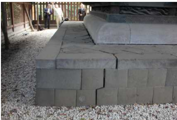
写真2 (修理前の亀裂・ズレ等の状況)
