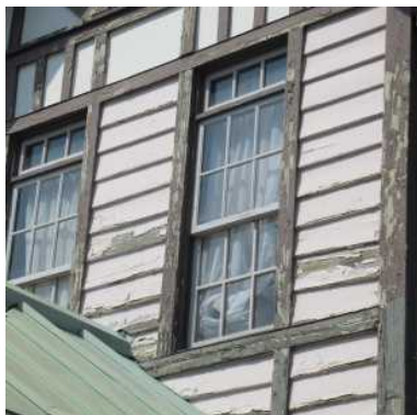
修理前（損傷箇所）
