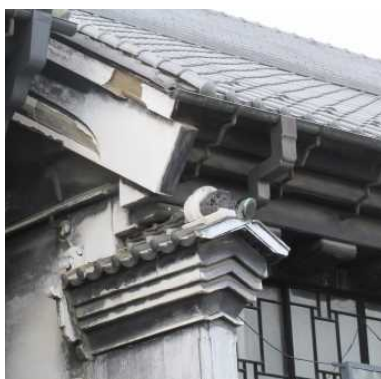
修理前（損傷箇所）
