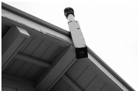
屋根の西側側面の中央にある尖塔上の飾りの下部が落下
