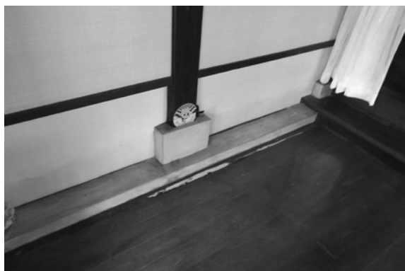
1階の店部分の東側の壁に近い床板より白蟻が発生
