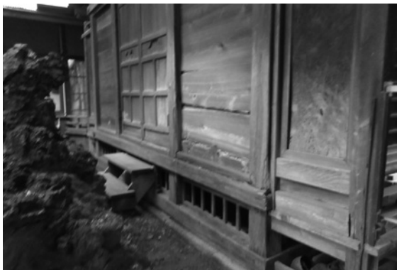
修理前（損傷箇所）
