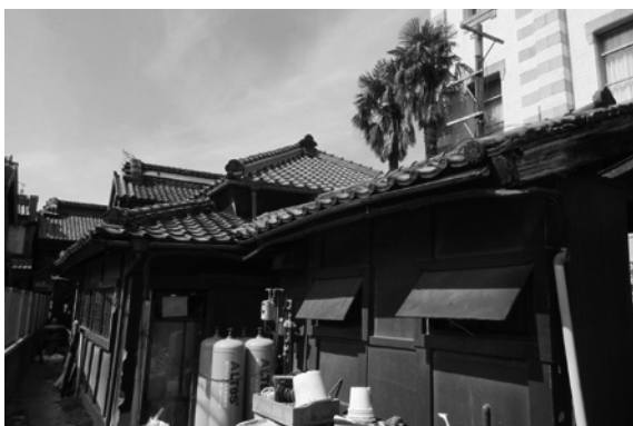
修理前（損傷箇所）
