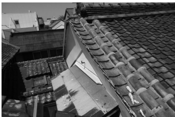
修理前（損傷箇所）
