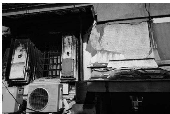
修理前（損傷箇所）
