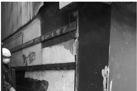
東側の壁面の壁面の漆喰が剥がれ、土が見えるところに防蟻処理
