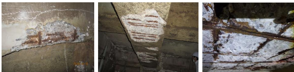
図 2-5 し尿貯留槽及び浄化槽汚泥貯留槽の劣化状況
