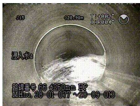
継手からの地下水の流入（管内調査）
