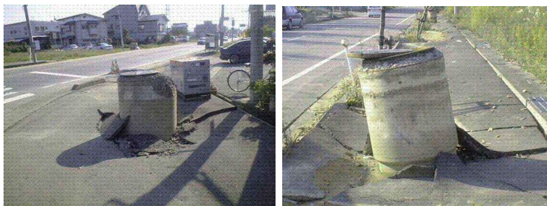
マンホール浮上状況（新潟県中越沖地震時の例）
