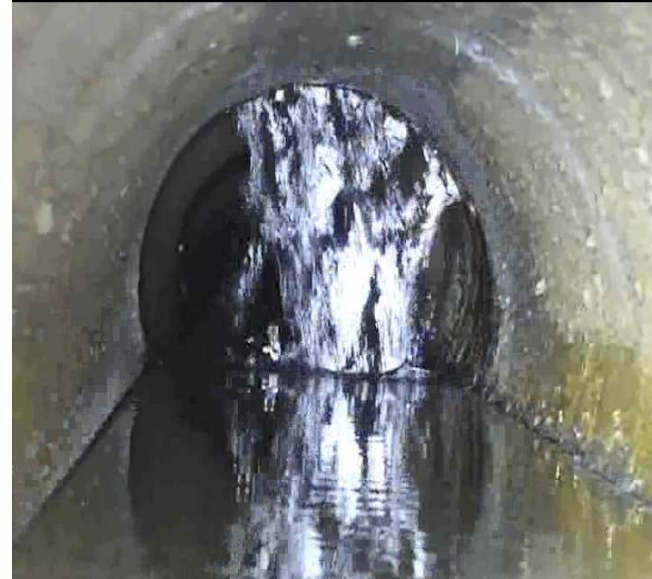
劣化した管の継ぎ手から浸入する様子
