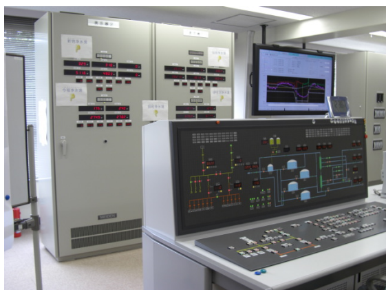
更新後の中福受水場 (管理棟・監視室)
