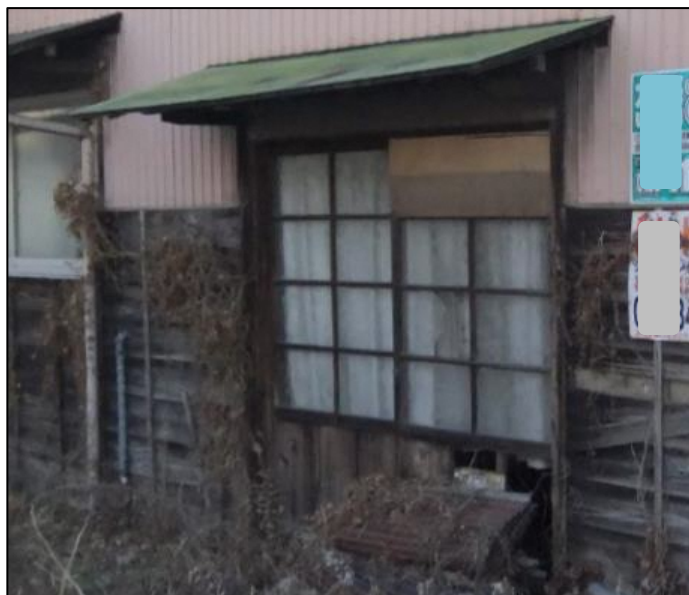
写真 25 窓ガラスの事例
