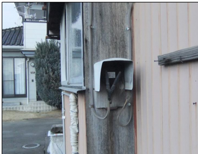
写真 16 電気メーターの事例
