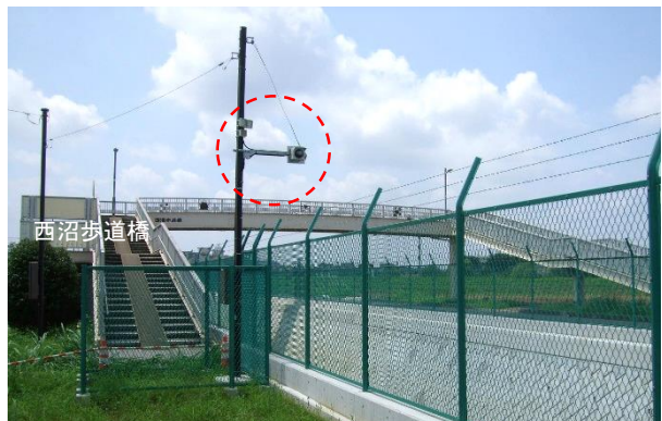
現地の状況を把握するための監視カメラを西沼歩道橋付近に設置(令和元年5月完成)
