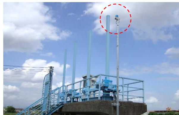
樋門閉鎖時に点灯する樋門表示灯を樋門に設置(平成30年9月完成)
