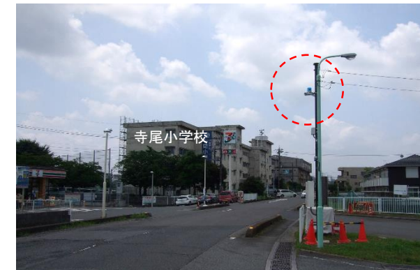
樋門閉鎖時に点灯する樋門表示灯を寺尾小学校北側に設置(令和元年7月完成)
