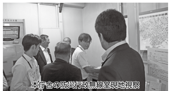
本庁舎の防災行政無線操作卓
