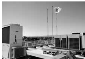
新たに本庁舎に設置した空調設備
