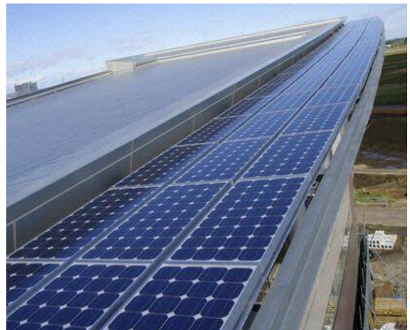
環境プラザ「つばさ館」(庇部分) 18.0kW
