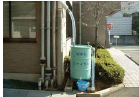
公共施設の雨水貯留施設
