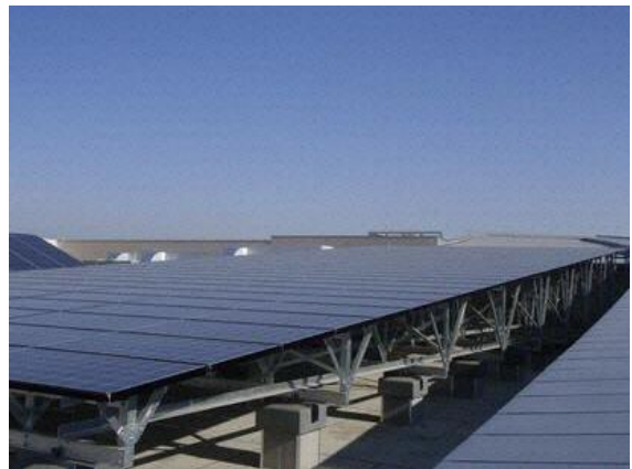
環境プラザ「つばさ館」(陸屋根型) 58.9kW
