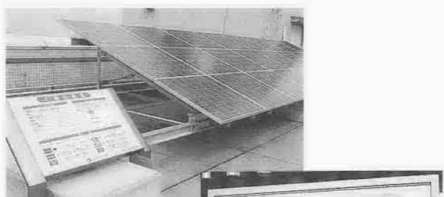
太陽光発電パネル (本庁舎屋上)
