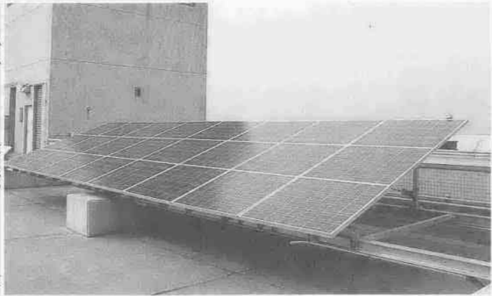
市役所本庁舎屋上に設置された太陽光発電パネル
