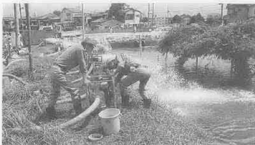
住宅地に流れ込んだ水をポンプで遊水池へ排水 (8月29日・下新河岸)
