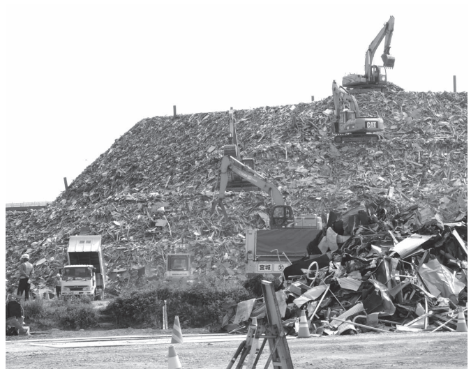
死者・行方不明者は3,595人・津波による浸水面積は73km 2 ・被災家屋は合計53,742棟と、単一の市町村として最大の被害を被った石巻市。写真は土砂が多く混ざった1次ガレキの山。被災地ではこのガレキの山を分別して2次ガレキとし、焼却・再利用・埋め立てといった処理が進んできている。
