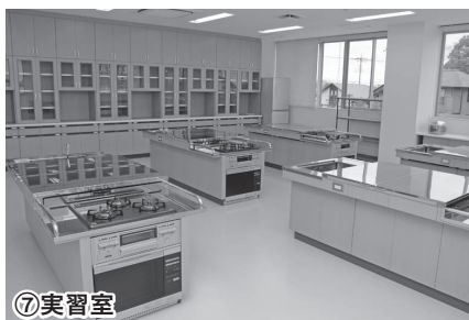
⑦実習室 調理設備の熱源は、災害時にも活用できるようプロパンガスを使用しています。
