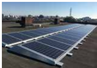
平成27年に野田中学校に設置した10kWの太陽光パネル
