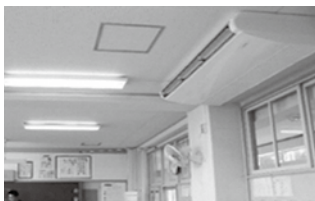
小学校の空調設備
