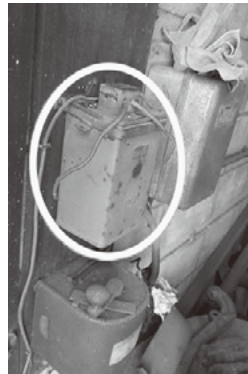
ポンプ小屋の低圧相相コンデンサー
