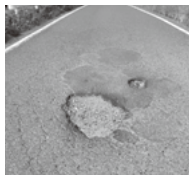
舗装がえぐれて穴が開いている
