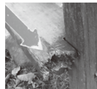
木製遊具の一部が腐食している
