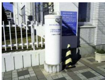
雨水小型貯留施設
