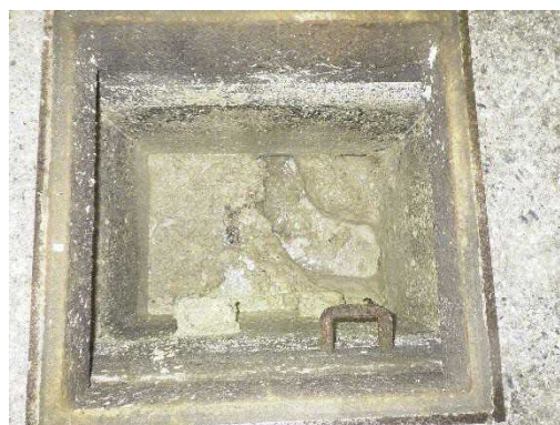
ラード等堆積状況 (人孔内点検)
