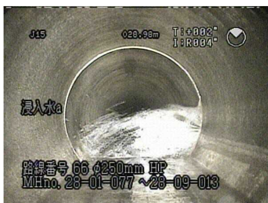
継手からの地下水の流入 (管内調査)
