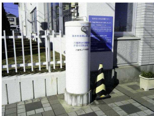
雨水小型貯留施設
