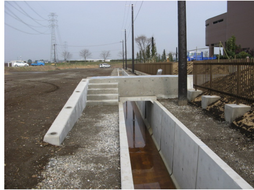
②高温水配管路 側面
