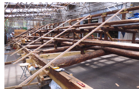
加工場で仮組みが行われる大屋根。組み立てながら歪みが無いか確認し、部材を修復する。
