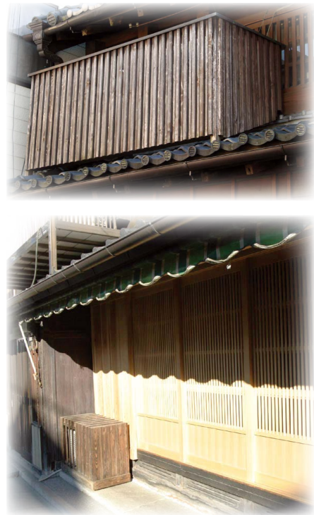
屋外空調設備に建物と一体感のあるデザインにした目隠しを設けた例
