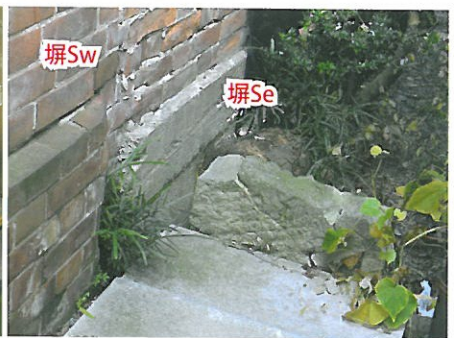
写真6 塀Sw・塀Se南面 目地も基礎のモルタルも塗られていない。塀Seと基礎が弧を描いて収束する塀Swの基礎。
