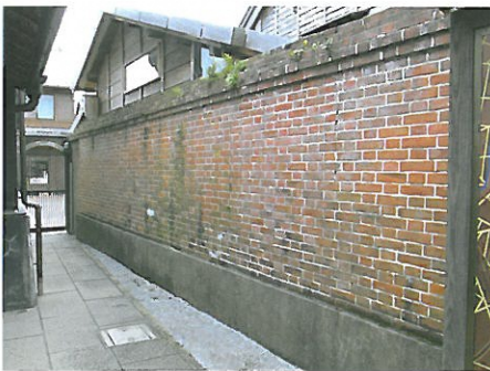
写真1 塀Se~アーチ部分近景 基礎はコンクリート造でモルタル仕上げ。 壁の厚さは煉瓦の長手1個分。
