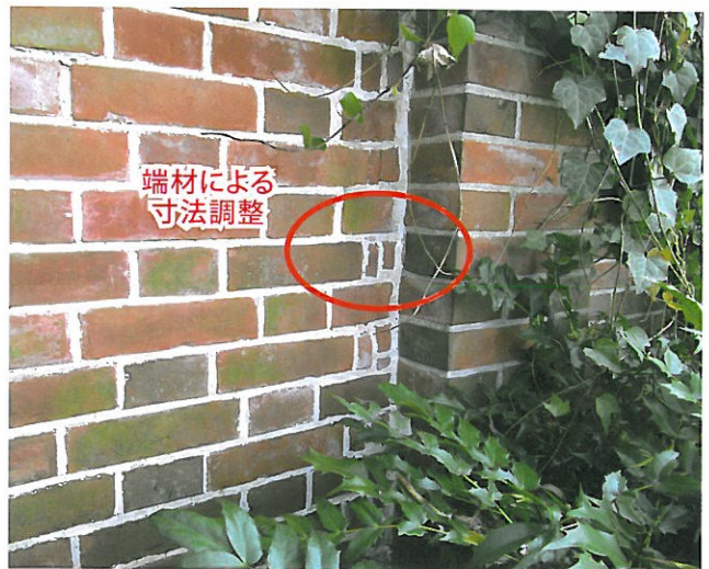
写真7 塀Se西端部・控1東側部分 東から伸びてきた塀Seが控1に突き当たる部分で、端材による調整が行われている。また、目地も控1に合わせるように上方に上がっている。
